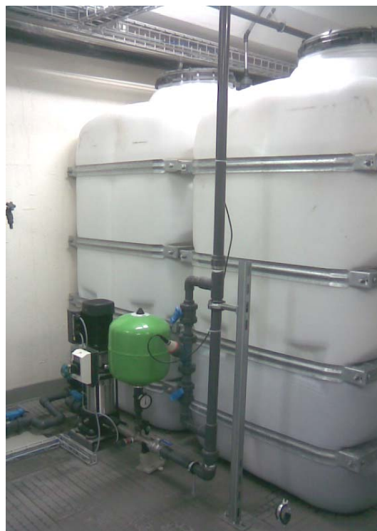
Cuves de stockage KLA, 2 x 4 m 3 , avec surpresseur
