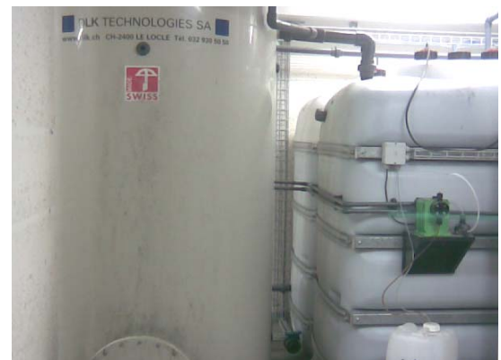
Installation FBR pour 10 m 3 par jour avec neutralisation
