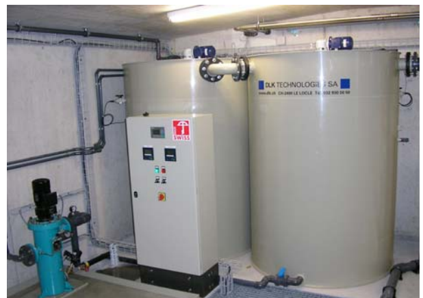
Installation KLA « A » avec filtre à rinçage automatique, correction du pH dans 2 sens et oxydation chimique
