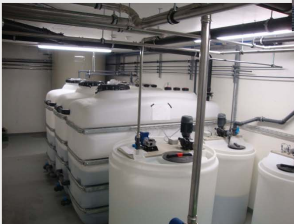
Cuve de stockage et doseurs Au fond, on voit le bas du décanteur
