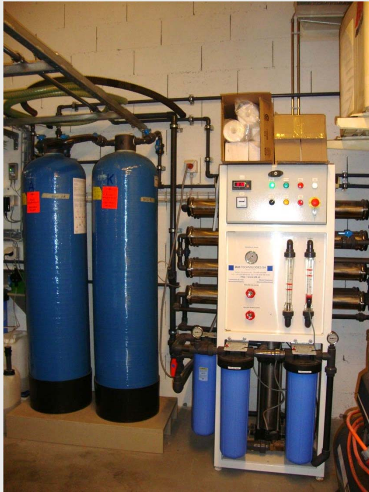
L'osmose inverse, exemple
