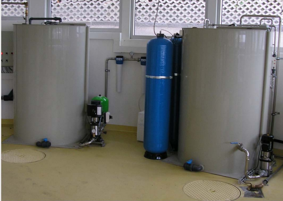
L'osmose inverse, exemple
